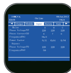
Контрольная панель шкафа ИБП
