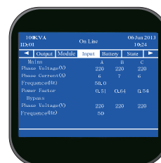
Контрольная панель шкафа ИБП
